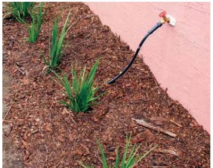
Mueva las plantas que bloqueen las corrientes de aire o interfieran con el mantenimiento de la casa.
